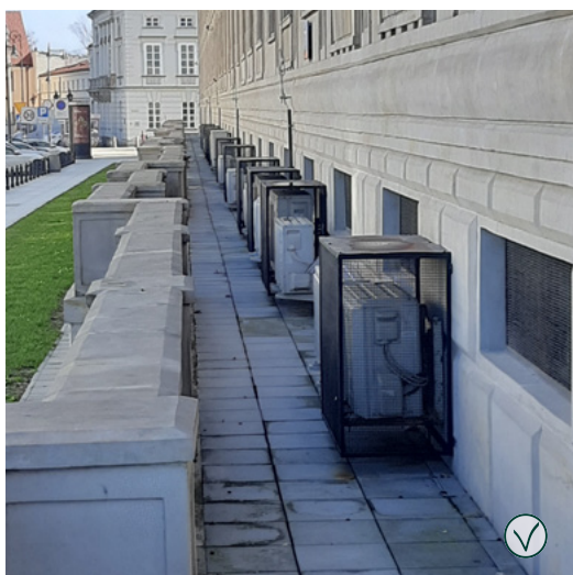
4. Urządzenia zabezpieczone i ukryte za balustradą – Królewska 1/7.
