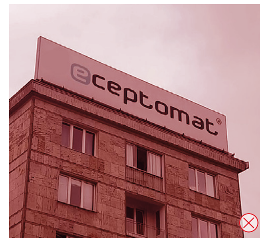
6. Kasetony reklamowe na dachach trzeba zdjąć lub wymienić na ażurowe – Al. Jerozolimskie 8.
