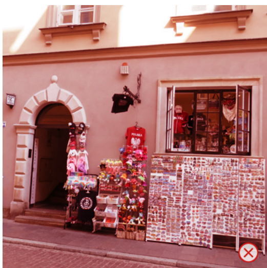
4. Nielegalna wystawka przed sklepem rujnująca świeżo odremontowaną elewację – Świętojańska 12.
